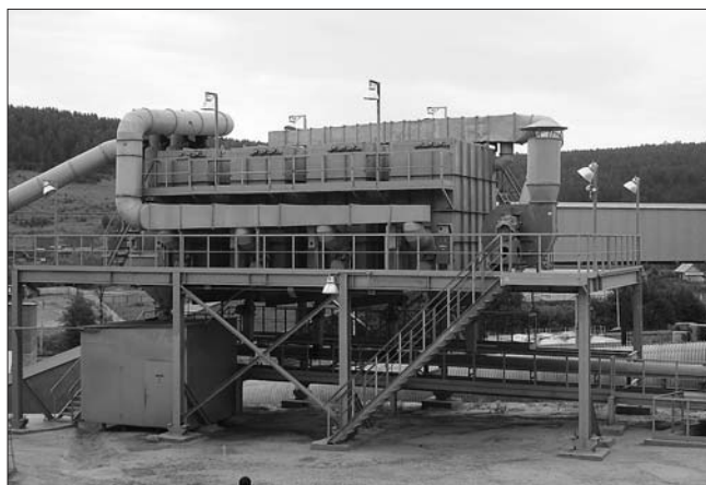
Рис. 1. Аспирационно-пылеулавливающая установка, расположенная на открытом воздухе
